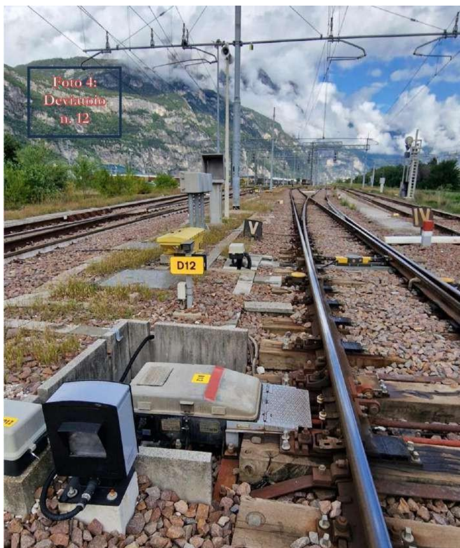
Fig. 4: Cassa di manovra in corrispondenza della punta scambio del deviatoio n. 12 (Fonte: RFI).
