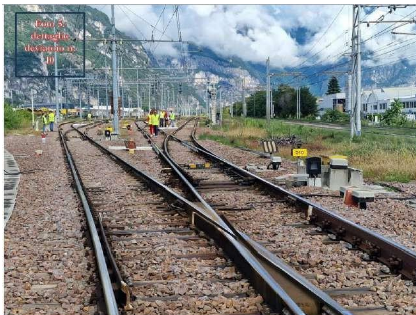
Fig. 5: Cassa di manovra in corrispondenza della punta scambio del deviatoio n° 10 (Fonte: RFI).
