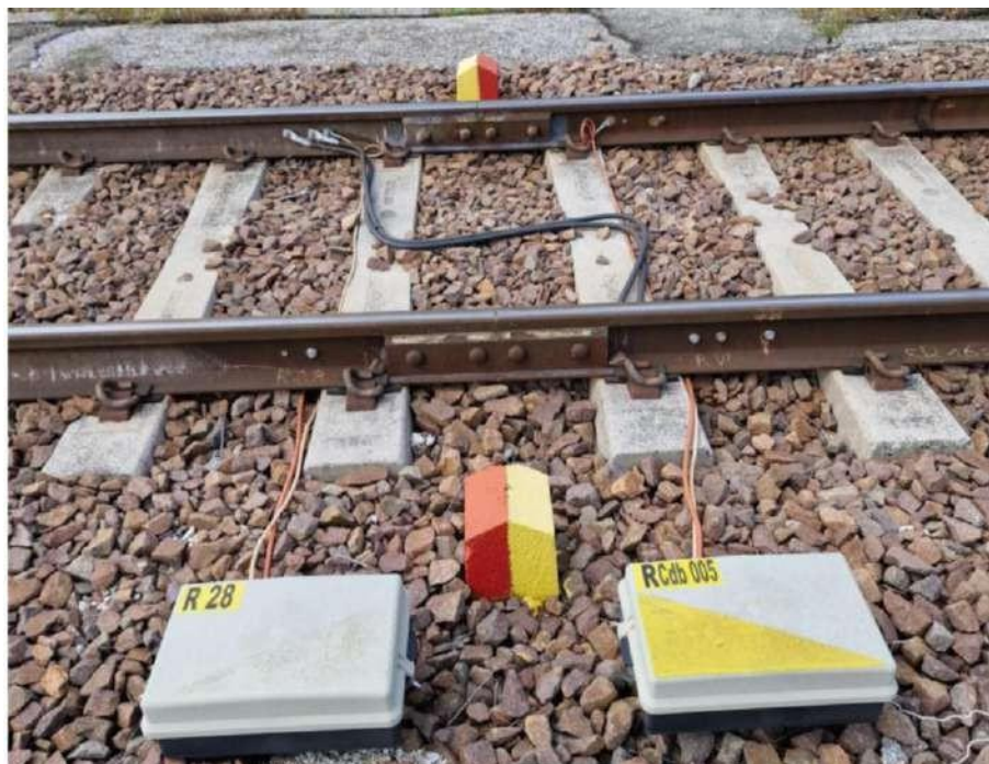
Fig. 3: Particolare di cassette del CdB del binario V (Fonte: RFI).
