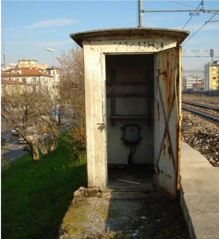
Foto n. 8 – Locale tecnico in disuso – Stazione di Bergamo (dicembre 2015)
