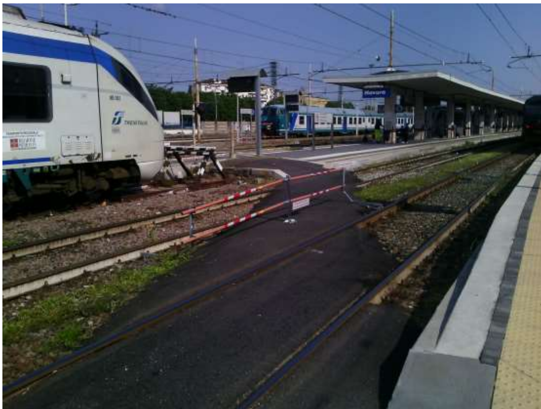
Foto n. 16 - Stazione di Novara - barriere verticali temporanee a protezione area di cantiere (maggio 2016)
