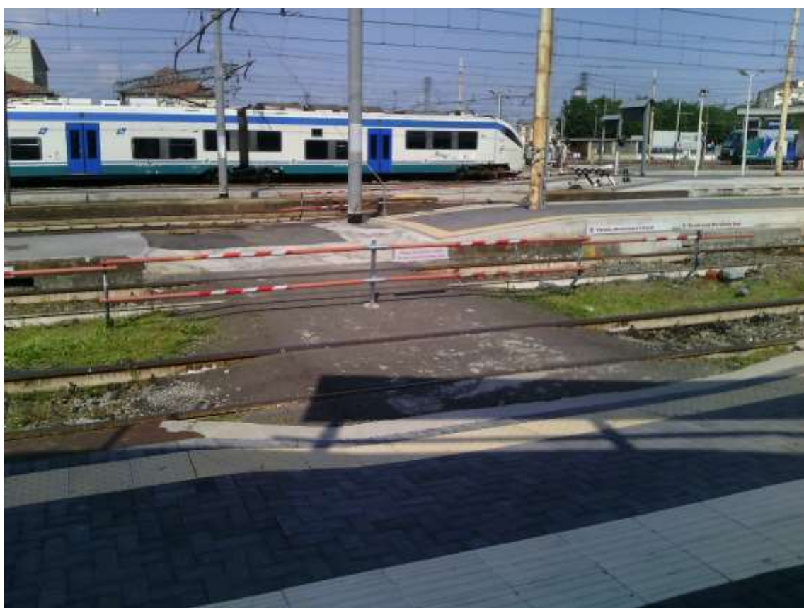
Foto n. 17 - Stazione di Novara - barriere verticali temporanee a protezione area di cantiere (maggio 2016)
