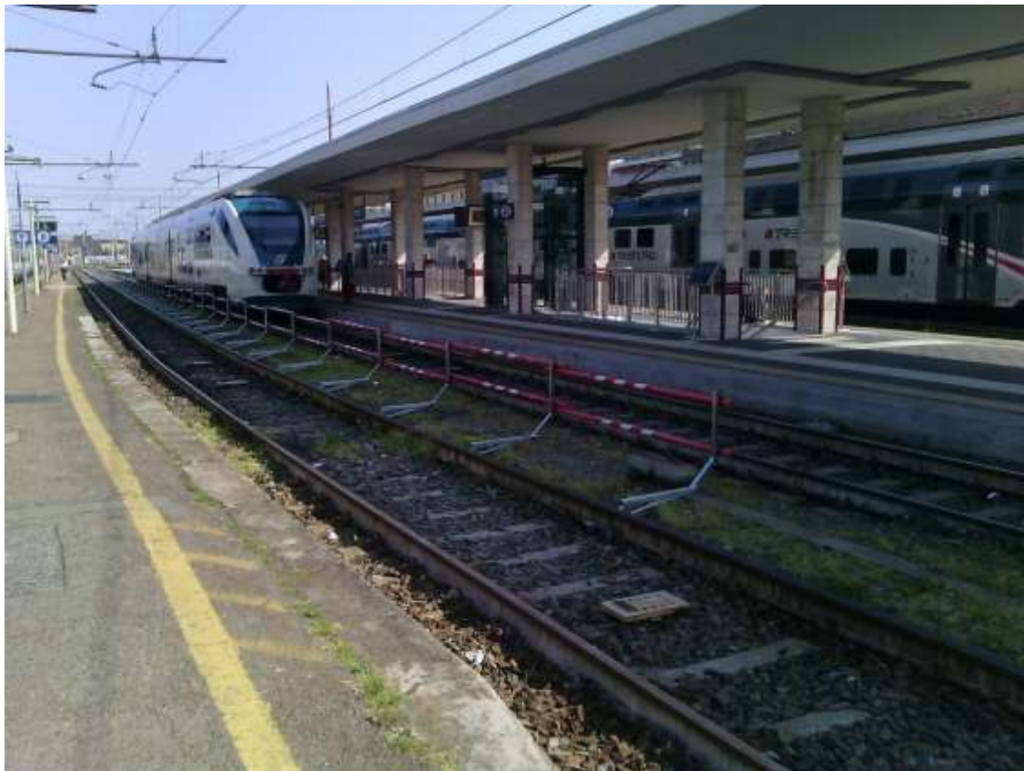
Foto n. 15 - Stazione di Novara - barriere verticali temporanee a protezione area di cantiere (maggio 2016)
