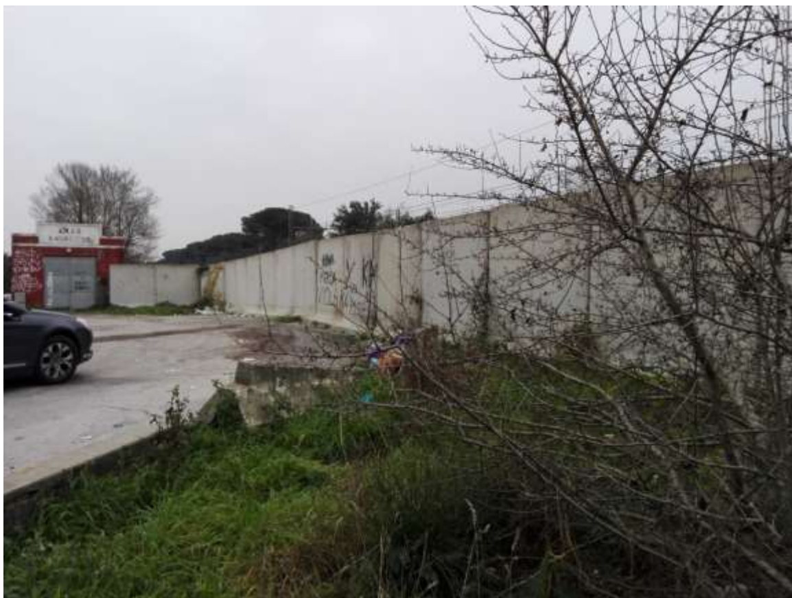
Foto n. 20 –Recinzione in pannelli di cemento in prossimità ex Passaggio a Livello Via Vecchianese (dicembre 2015)
