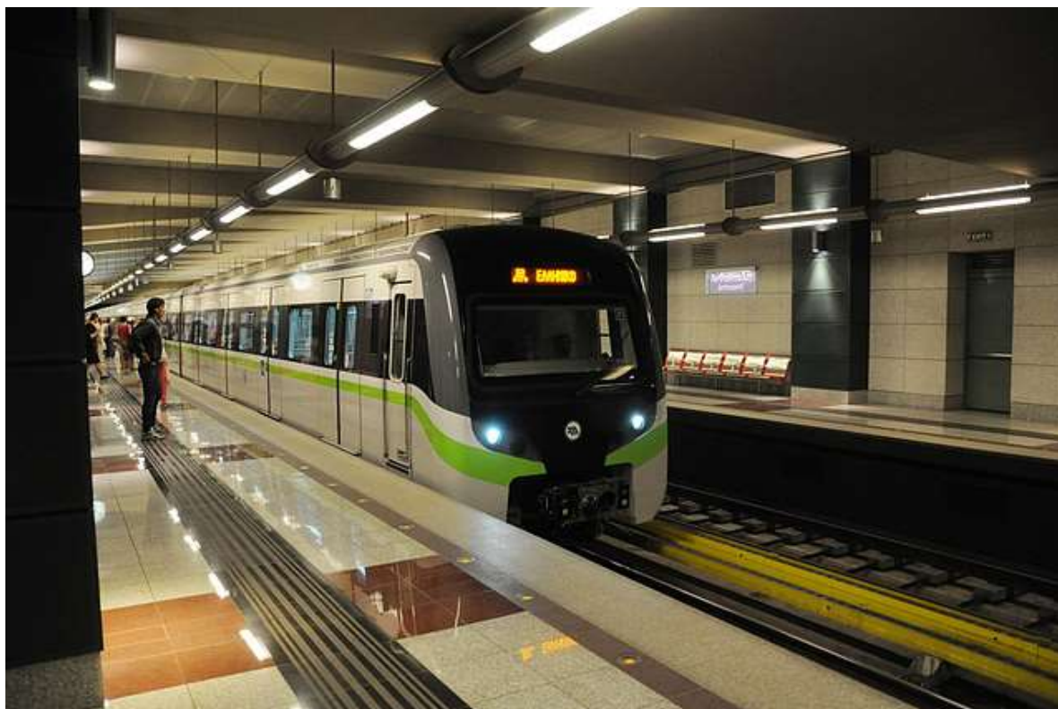
Foto n. 11b - Esempio di delineatori di margine a LED per banchine – Atene – Linea Metro 2 Anthoupoli Station
