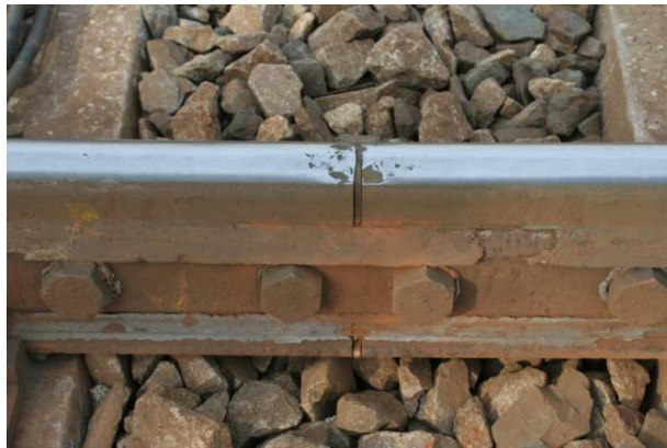
Abrasioni da slittamento sulle testate Bicchieramento delle testate Scollamento ganasce-rotaie con presenza di ossido
