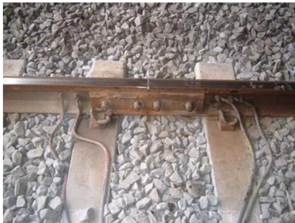
Massiccata con presenza di polvere bianca Errato posizionamento del GII rispetto alle traverse
