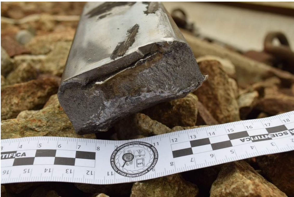
Figura 48 – Spezzone della rotaia del GII distaccata, vista del fungo dal lato della frattura (fonte: Polizia Scientifica)
