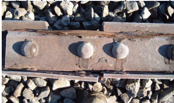
GII rotto tolto d'opera: Scollamento ganasce-rotaie Luce eccessiva fra le testate Propagazione di cretti partenti dai fori Cedimento della suola
