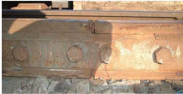
GII tolto d'opera: Luce eccessiva fra le testate Scollamento ganasce-rotaie Fenditura trasversale nel fungo per propagazione di cretti partenti dai fori
