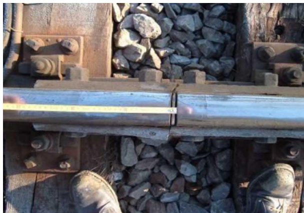
Scollamento ganasce-rotaie Luce eccessiva fra le testate (scorrimento)
