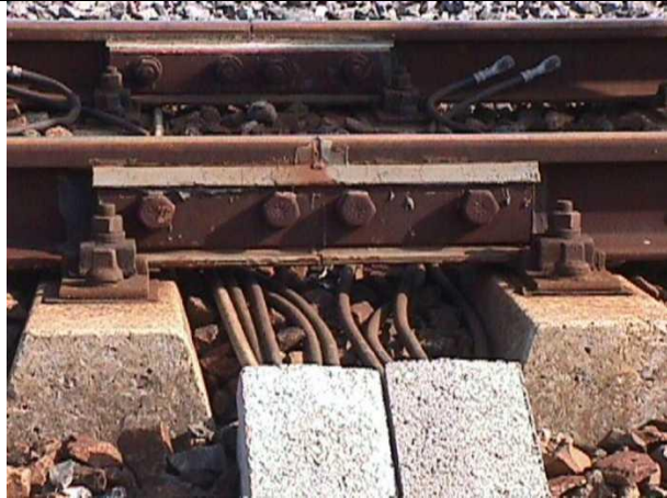
Pietriscio insufficiente per presenza di cavi Inizio di scollamento evidenziato da ossido
