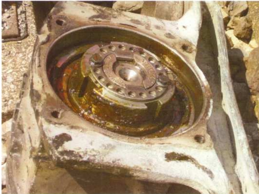
Stato di lubrificazione della boccola - Fonte Commissione Ministeriale di Indagine
