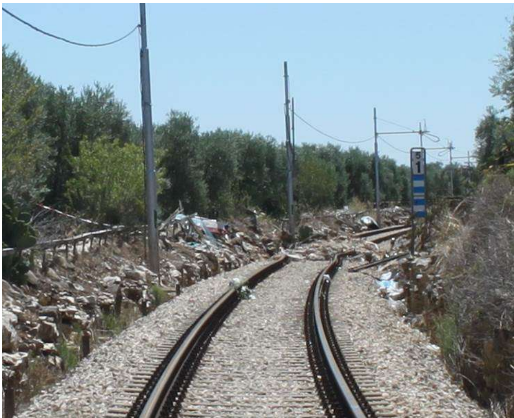
Figura 4 - Punto di collisione (km 51)
