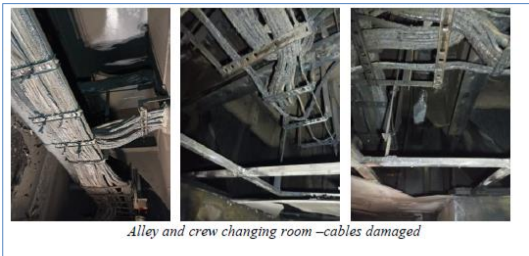
Figura 58 - fasci di cavi danneggiati dall'incendio nel locale spogliatoio e in corridoio – Fonte: report HT
