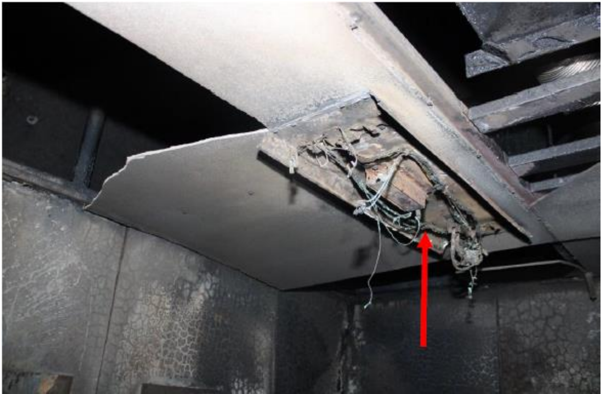
Figura 41 – La lampada di prora. Si noti che non è presente la protezione. La posizione approssimativa del danno localizzato da fusione al cablaggio interno è indicata dalla freccia - Fonte: report BURGOYNES
