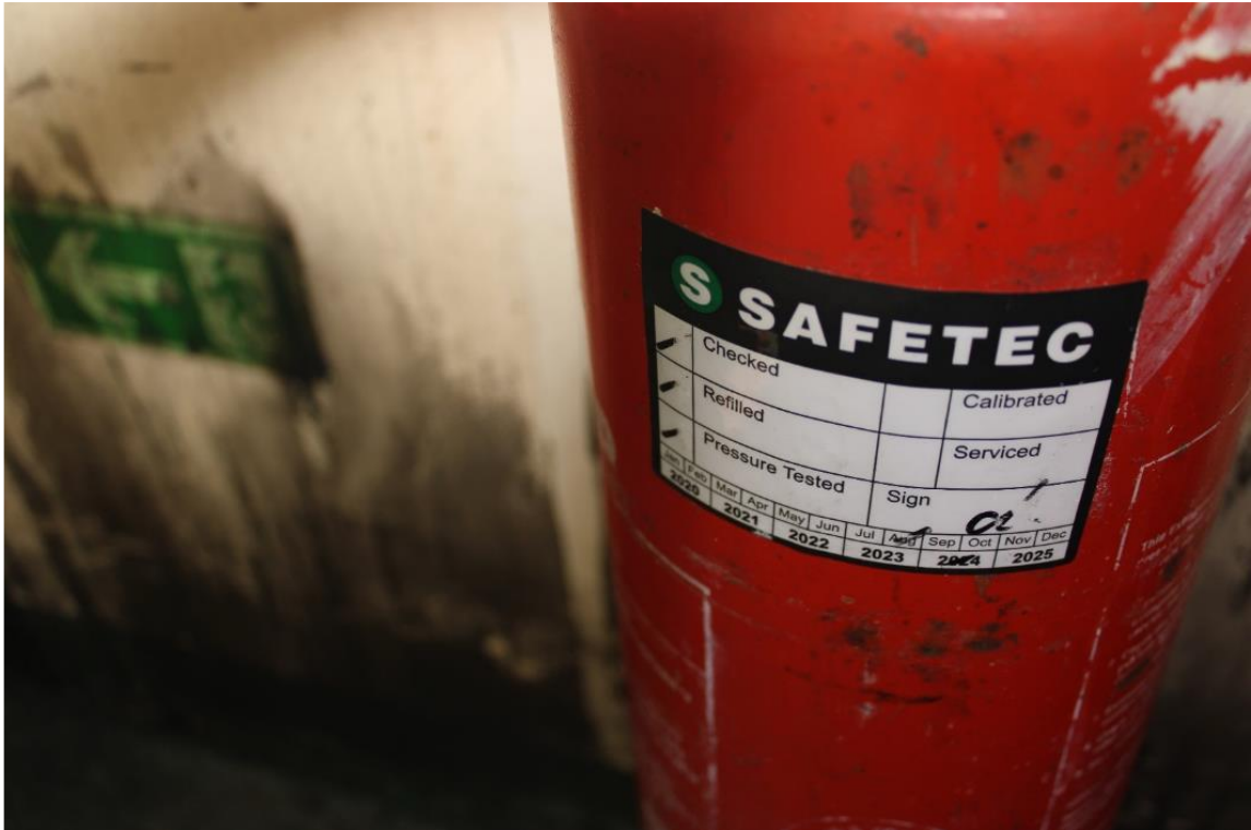
Figura 49 – Una targhetta relativa ai controlli datata agosto 2024 su uno degli estintori trovati vicino allo spogliatoio - Fonte: report BURGOYNES
