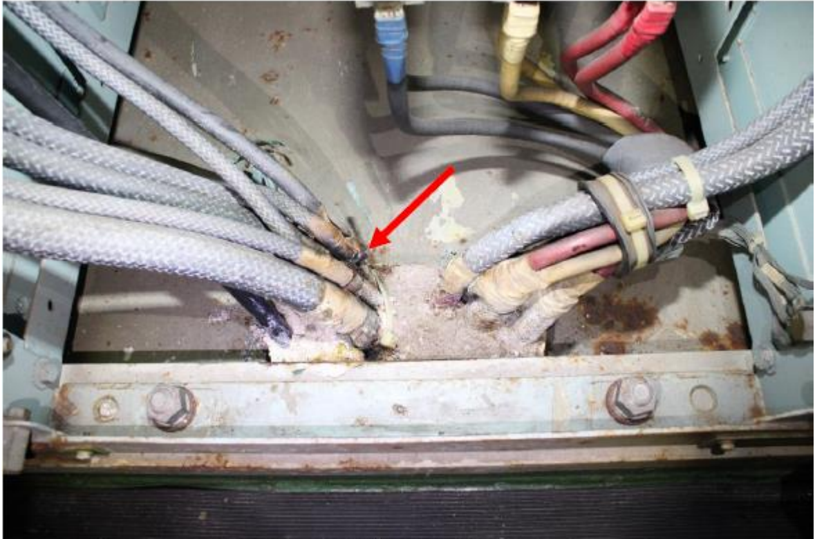
Figura 16 - Danni causati dall'incendio ai cavi instradati attraverso un passaggio a ponte verso l'ESB – Fonte: report BURGOYNES
