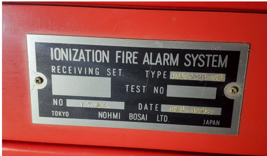
Figura 78 - targhetta apposta sul quadro allarmi incendi in plancia, con indicazione dell'anno di costruzione 1998 e del fabbricante giapponese - Fonte: fotografia dell'investigatore
