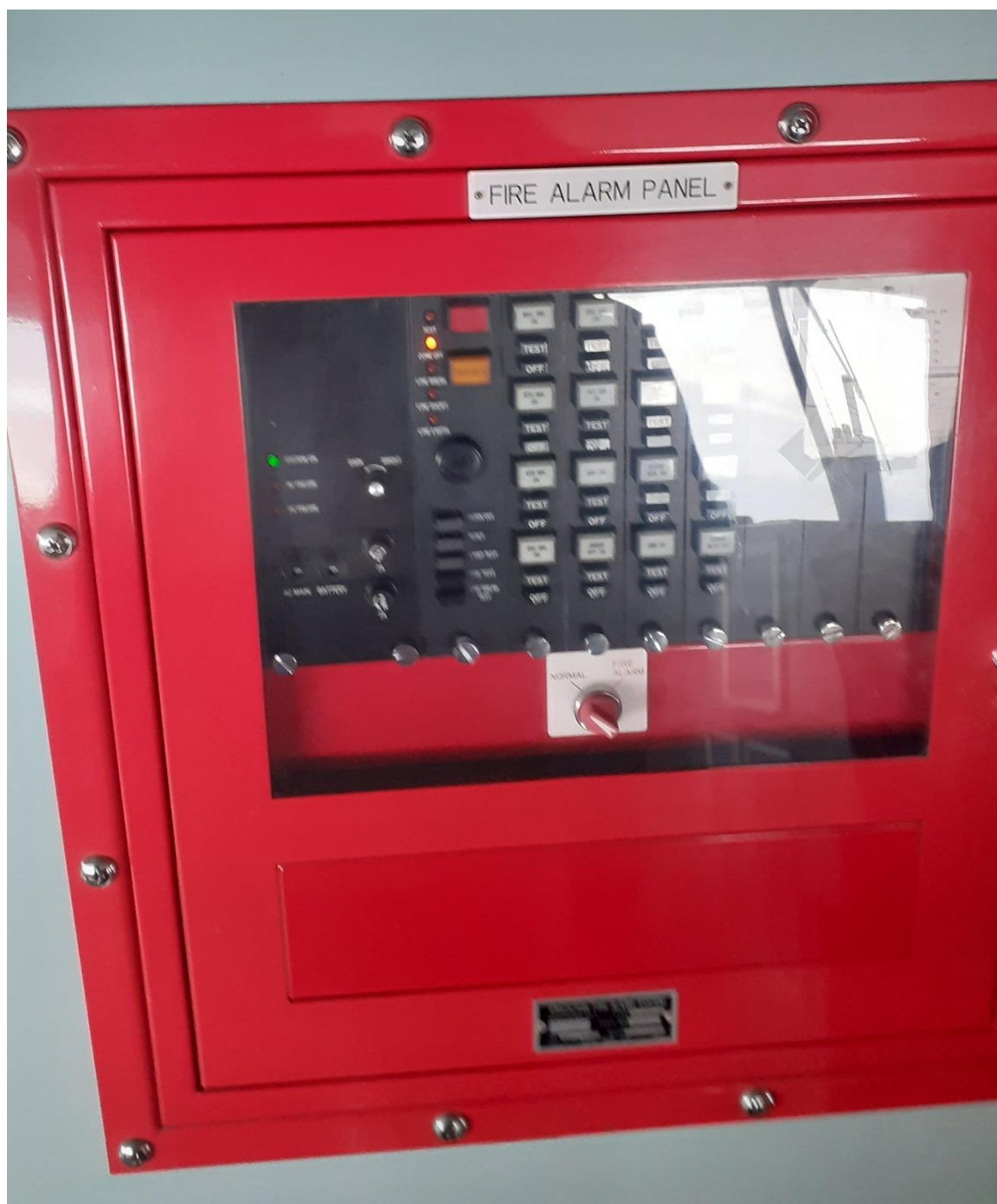
Figura 76 - pannello allarmi incendio in plancia della M/N STAR ISTIND Fonte: fotografia dell'investigatore
