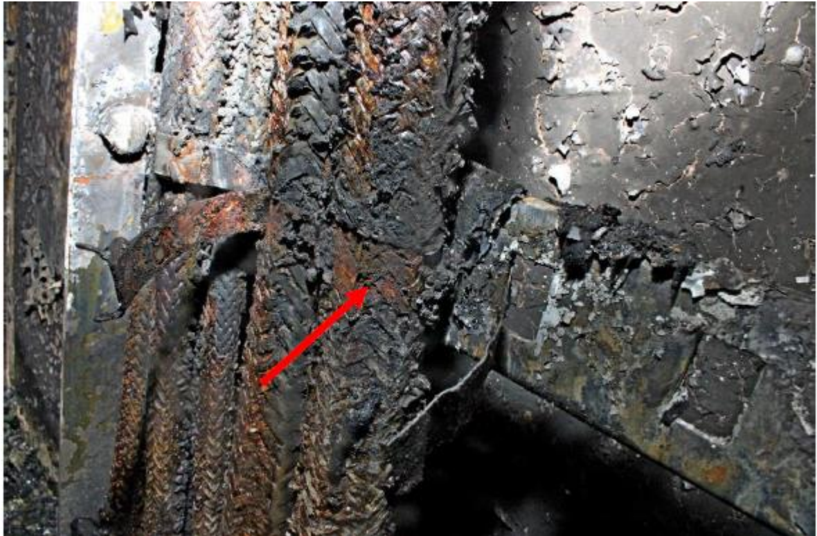
Figura 35 - La fascetta inferiore che fissava i cavi all'ESB dopo la rimozione, che mostra la treccia metallica non danneggiata sottostante (indicata dalla freccia) – Fonte: report BURGOYNES
