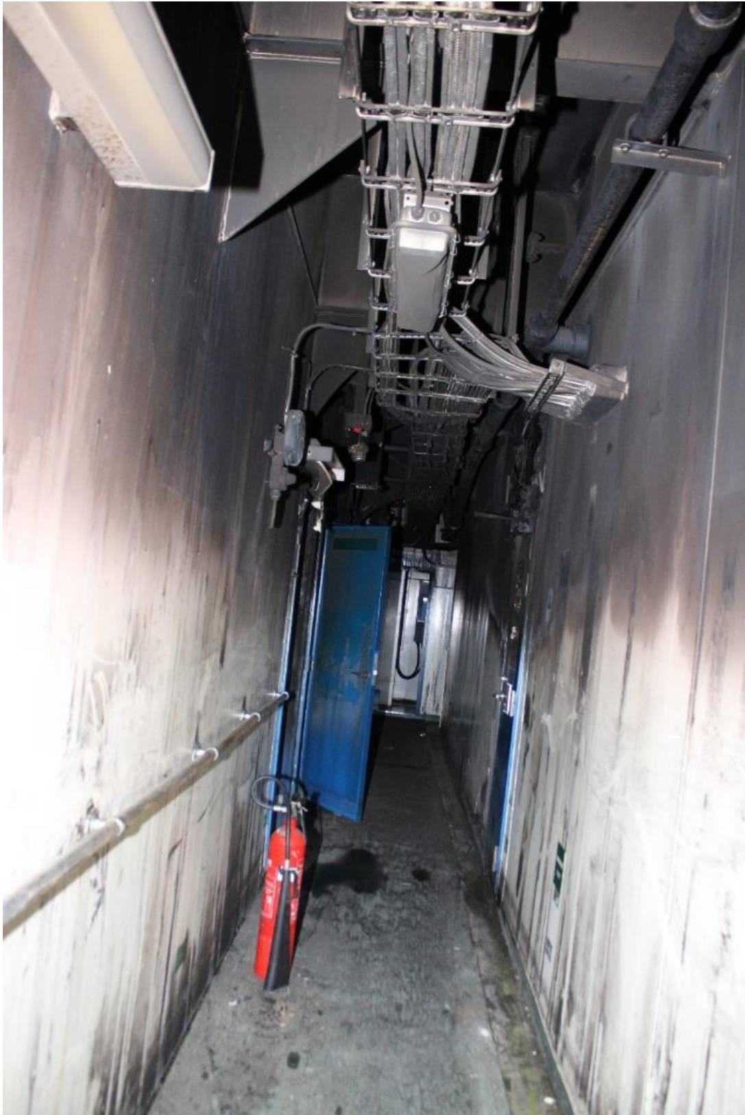
Figura 17 – danni da fumo e calore nella parte alta del corridoio dello Under Upper Deck. La porta azzurra aperta è quella dello spogliatoio – Fonte: report BURGOYNES
