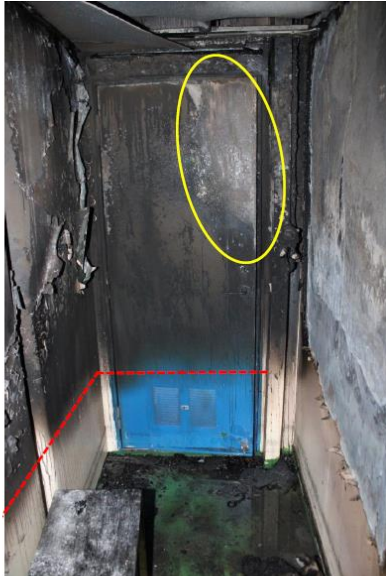
Figura 20- La superficie interna della porta dello spogliatoio, che mostra il danno diretto causato dal fuoco all'angolo superiore (cerchiato) e il livello del piano neutro (linea tratteggiata rossa). Si notino le due griglie di aereazione poste nella parte bassa della porta – Fonte: report BURGOYNES
