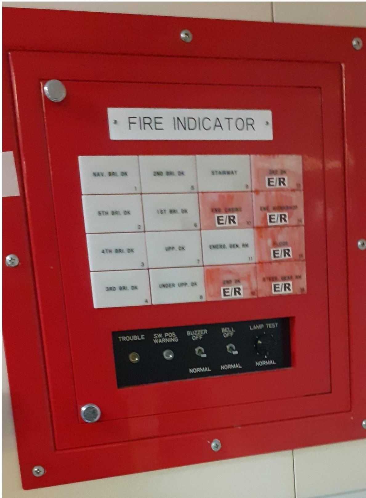
Figura 79 - pannello allarmi incendio in Engine Control Room - Fonte: fotografia dell'investigatore
