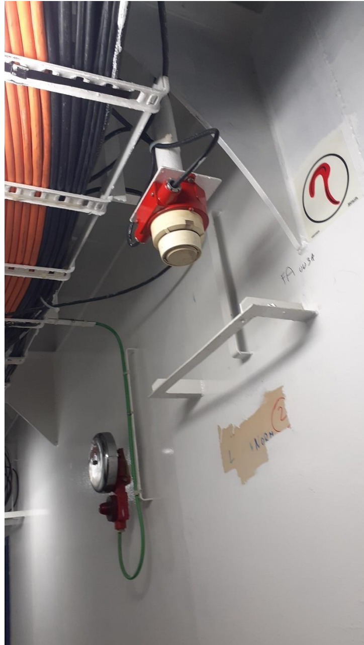
Figura 80 - la sonda allarme fumo nel corridoio al di fuori del locale lavanderia- Fonte: fotografia dell'investigatore il 20/01/2025, dopo la sostituzione della sonda nel corso dei lavori di riparazione)
