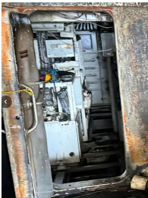
Figura 21 - Particolare engine room (Fonte Capitaneria di Porto di Olbia)
