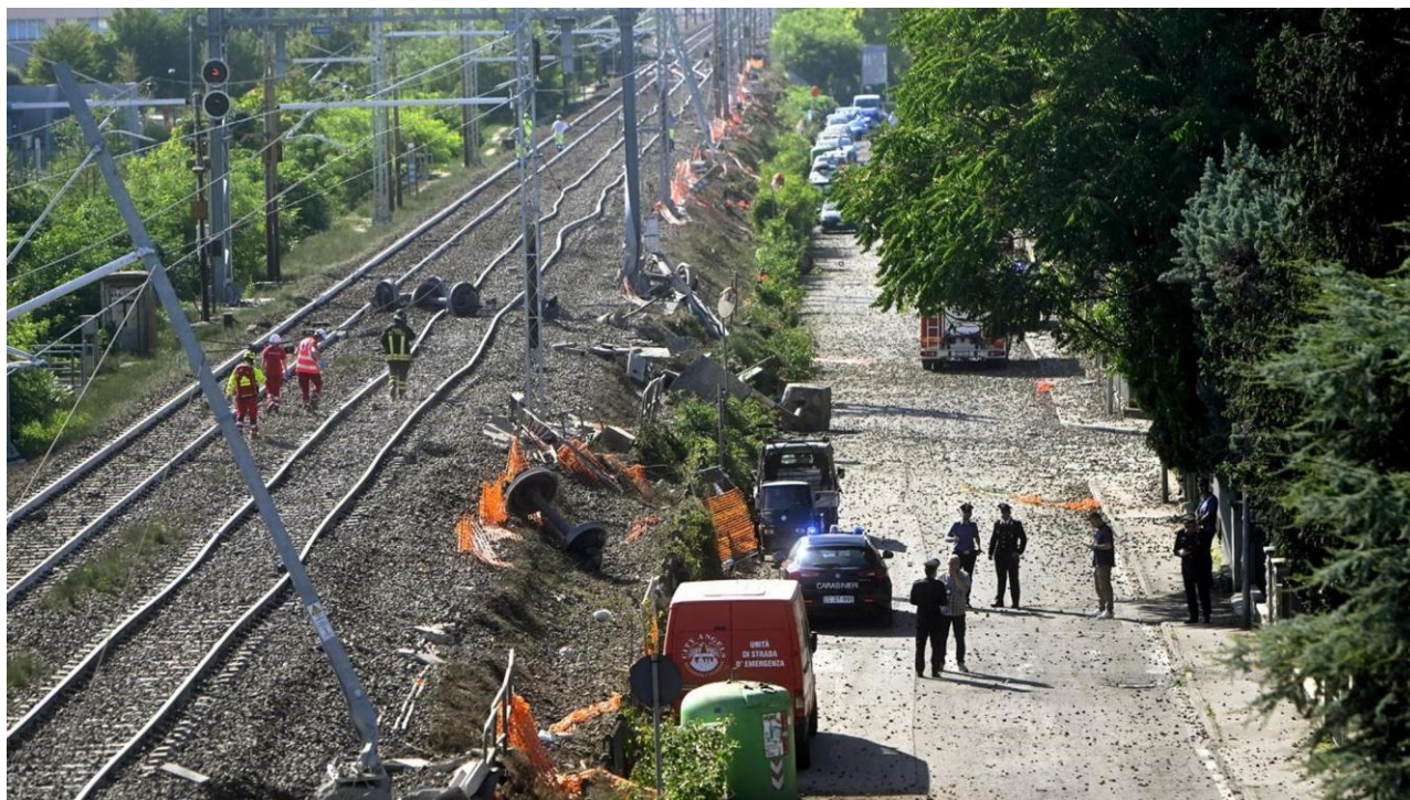
Fig. 14 – Stato del binario dopo il verificarsi dell’evento (Fonte Web).
