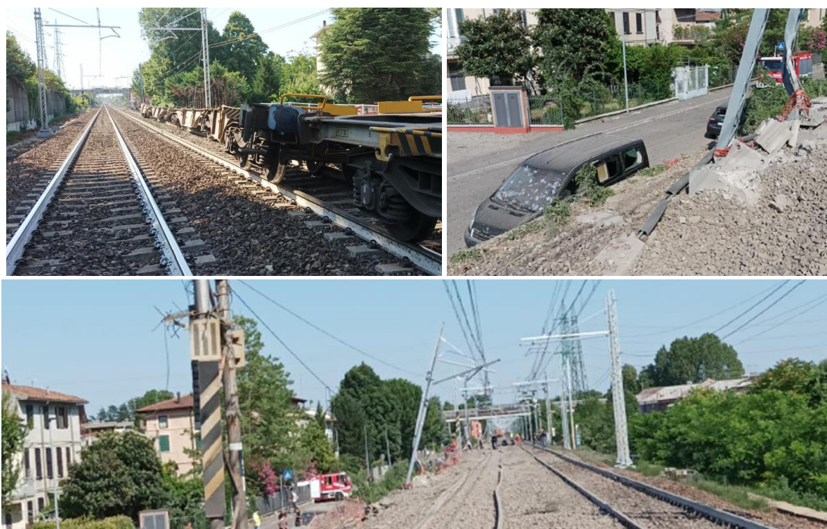
Fig. 3.1, 3.2, 3.3 – Danni all'infrastruttura a seguito dell'evento (Fonte RFI).
