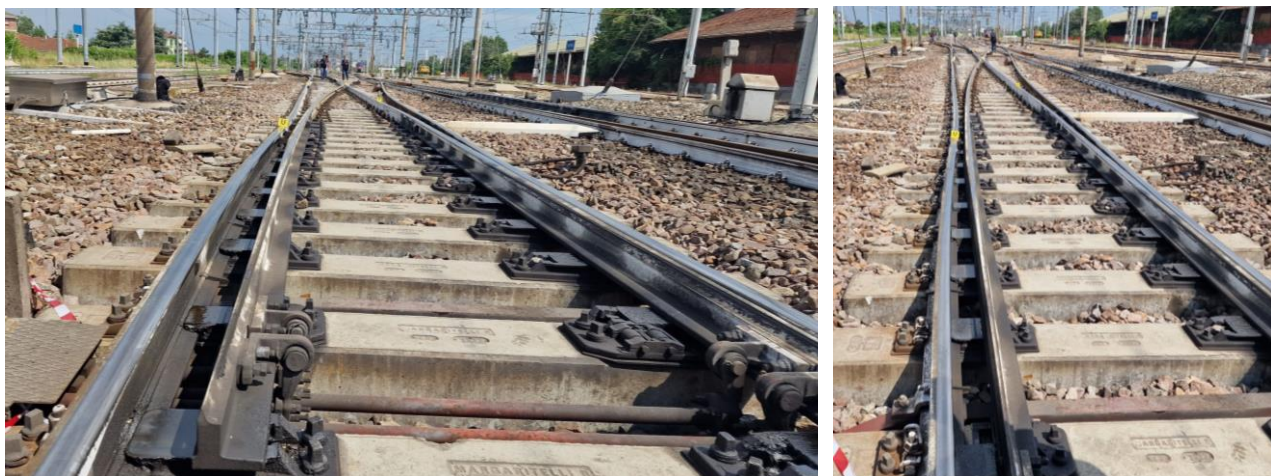
Fig. 13.1 e 13.2 – Stato del deviatoio 8A dopo il verificarsi dell'evento (Fonte Ufficio).
