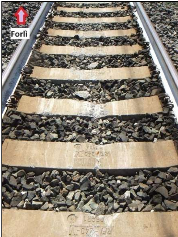
14.5 Particolare abrasioni (fonte Ufficio)
