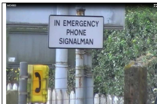
Figura 116: Telefono, e segnale sul posto che ne spiega l'uso, per una chiamata di emergenza al personale del GI che esercisce la linea, posto in corrispondenza del PL impresenziato di Milford nel Regno Unito
