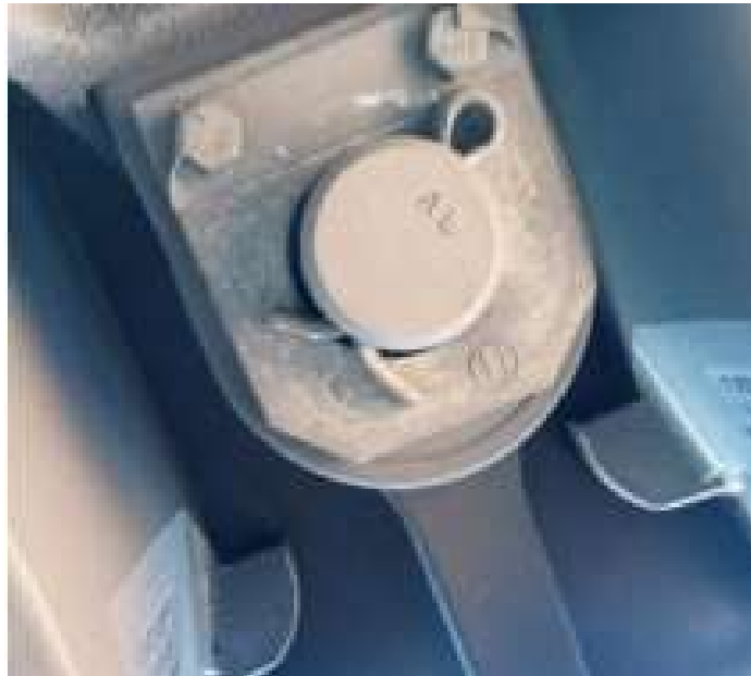
Figura 3 – Corretto bloccaggio dei bulloni del perno di trazione attraverso la piegatura dei lembi della piastrina (fonte GTS)
