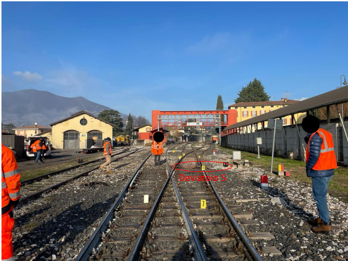
Figura 7 – Localizzazione del deviatoio 5 (fonte immagine: DiGIFeMa; elaborazione: DiGIFeMa)
