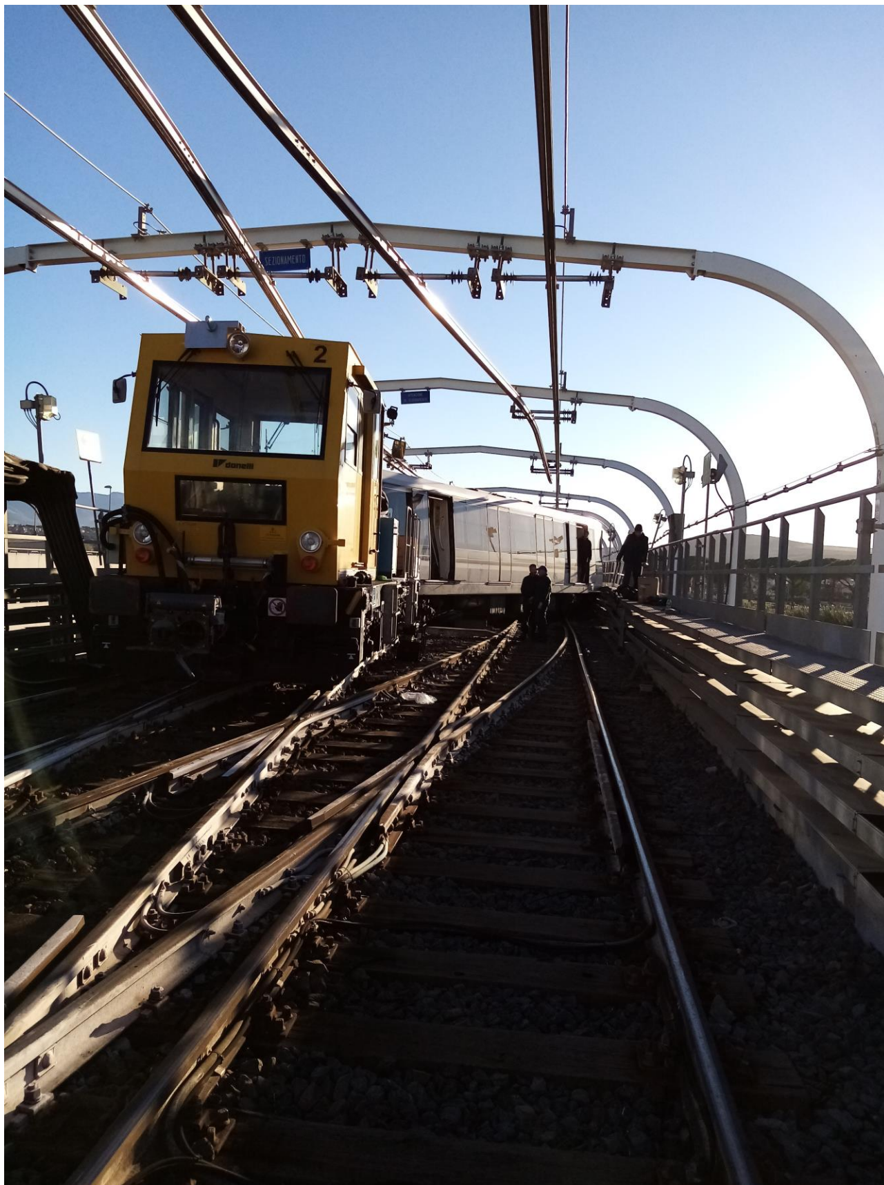
Foto 04: Particolare della rimozione del treno V002 deragliato (fonte DiGIFeMa)
