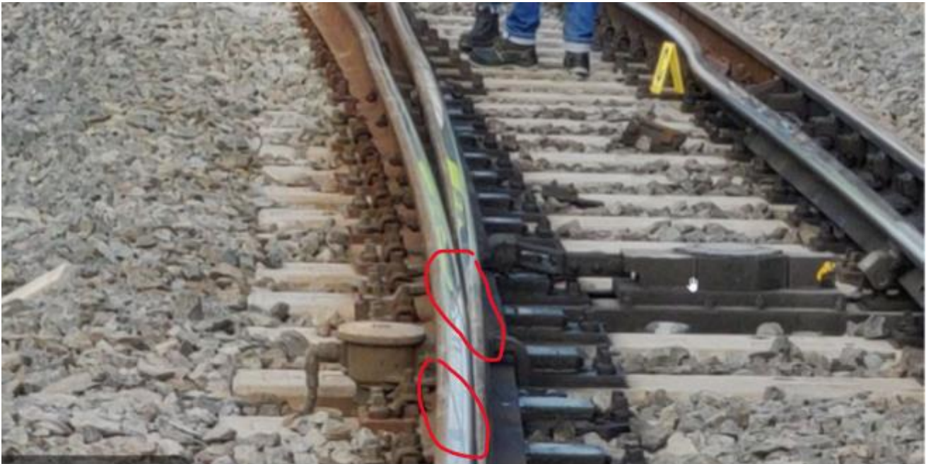
Figura 4: punti di sormonto del bordino della sala montata del locomotore di coda (elaborazione da fonte RFI)
