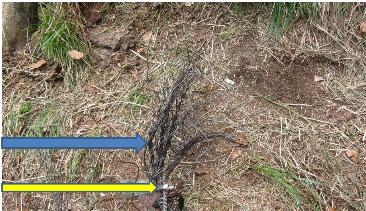
Foto 28 - Fune traente superiore nella zona di rottura; placchetta metallica per il circuito di sicurezza (freccia gialla) e i 6 trefoli aperti a pennello (freccia azzurra) - (fonte DiGIFeMa).
