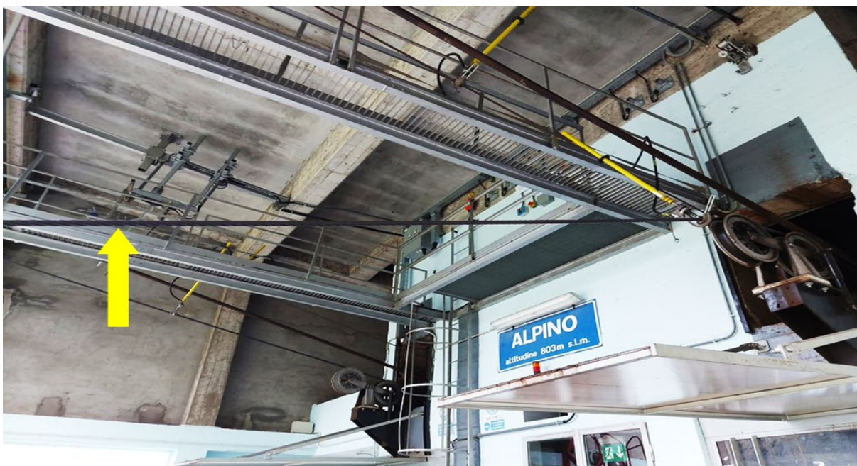
Foto 26 - Stazione Motrice di Alpino con cabina n.4 ferma per intervento del freno automatico sulla portante. Si nota la fune traente superiore (freccia gialla) che ha compiuto il giro puleggia e si appoggia sui rulli di uscita priva di tensione (fonte DiGIFeMa).
