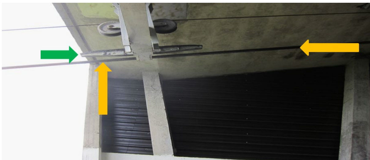
Foto 18 - Stazione di Rinvio e Tensione Mottarone: la portante (freccia arancione) della linea della cabina 3, a seguito della rottura della traente è uscita dalla scarpa (freccia verde) della guida della fune di stazione (Fonte DiGIFeMa).
