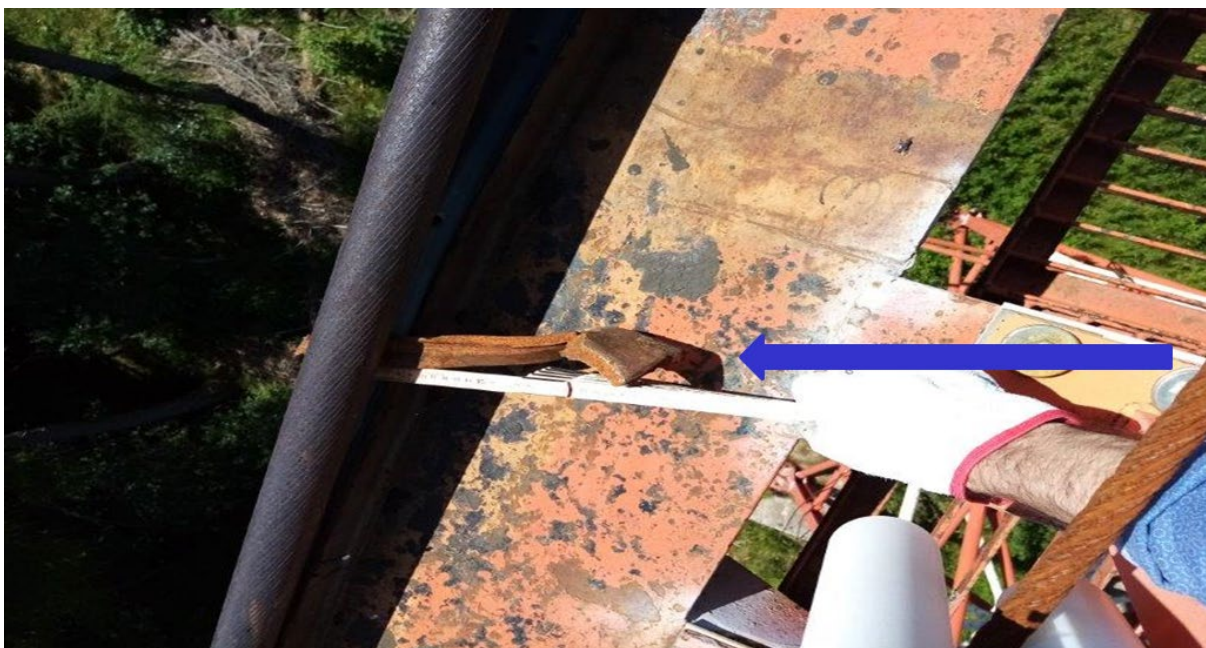
Foto 6 - Parte metallica di lunghezza 250 mm del carrello della cabina 3 incastrata tra la scarpa e la portante lato veicolo 3 (freccia blu) (Fonte DiGIFeMa).
