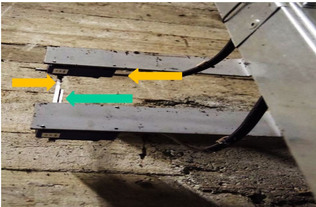
Foto 23 - Particolare del fine corsa bistabile a squadra a 90° per l'allarme (freccie arancio) e del fine corsa dell'arresto di urgenza (freccia verde). Entrambi risultano posizionati in modo da rendere inefficace il movimento discesa-salita del riscontro metallico posto al fondo del contrappeso (Fonte DiGIFeMa 01/06/2021).
