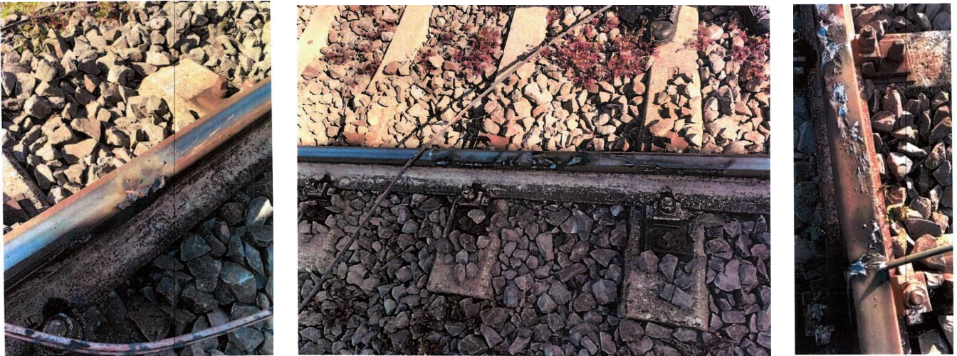
9. Rotaia danneggiata ( Fonte ATAC )
