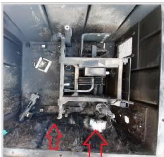
42. JR danneggiato dal principio di incendio (Fonte ATAC)
