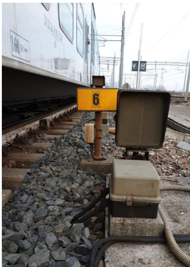
19. Deviatoio n. 6, segnalazioni spente (fonte RFI)
