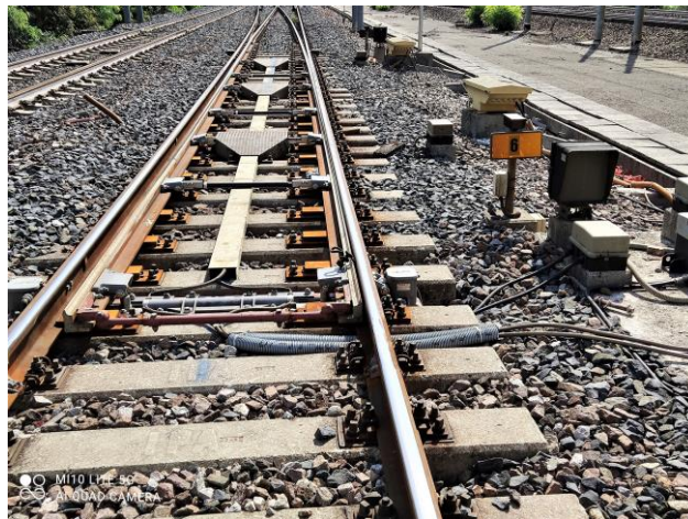
2. Deviatoio n.6 disposto per la deviazione
