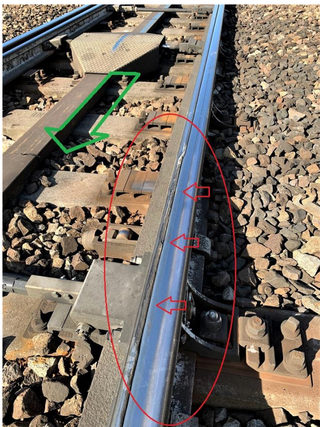
28. Abrasione ago sn deviatoio n. 6 (fonte RFI)
