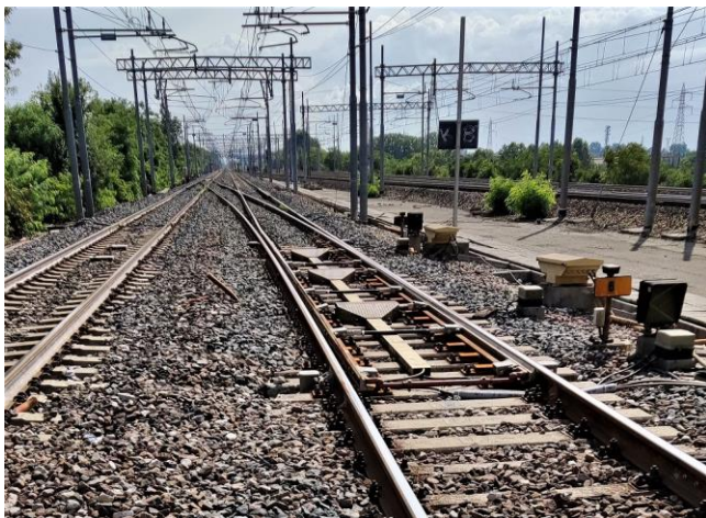
1. Linea Treviglio Ovest - Bergamo. Deviatoio n.6
