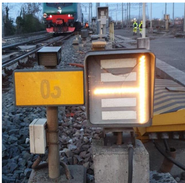
20. Deviatoio n. 5, segnalazioni accese (fonte RFI)
